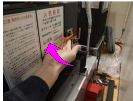
手前のバルブを上げて閉める
