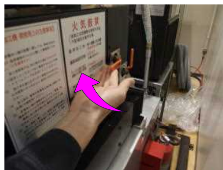
手前のバルブを上げて閉める
