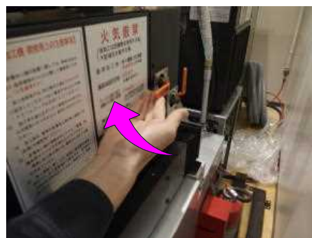
手前のバルブを上げて閉める
